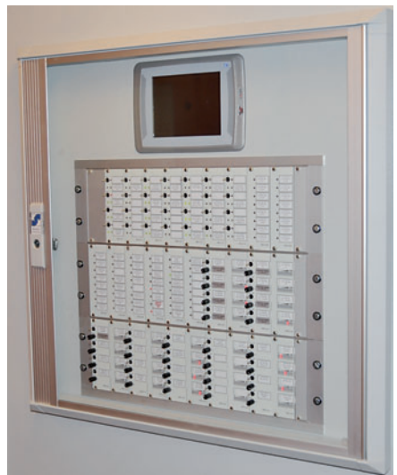
Die zentrale Steuerung der Gebäudeleittechnik
