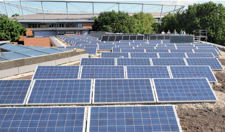
PV- und Solarthermie-Anlage
