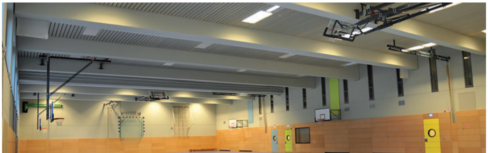
Aufteilung der Beleuchtung der Sporthalle in drei regelbare Felder.
